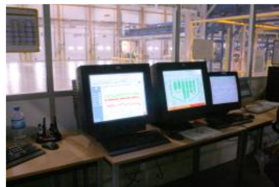
Le local de supervision surveille de près la machine
